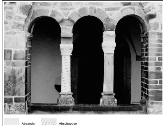
Fig. 2. Damage at two columns in a cloister (Unser Lieben Frauen, Magdeburg)
